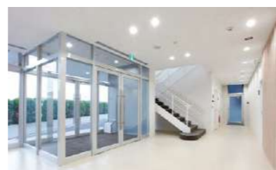
エントランスホール 天井には、ダウンライト形ノズルや結露防止カバー付製品を設置しています。
