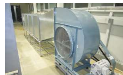
送風試験施設 ダンパー・VAVの送風試験が可能です。
