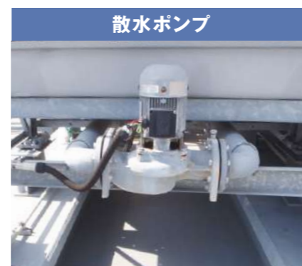
散水ポンプ 経年劣化により送水能力が低下しています。また腐食と水漏れも生じています。
