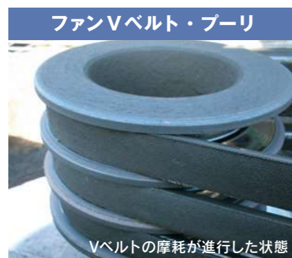
ファンVベルト・ブリー Vベルトの摩耗が進行した状態 ベルトがスリップしファンの回転数が減り熱交換率が悪くなります。破断する場合もあります。
