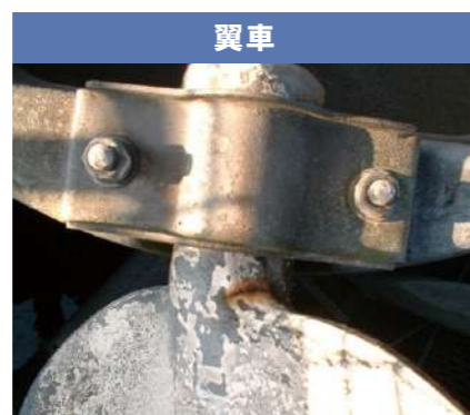
翼車 経年劣化により腐食と亀裂が生じています。(運転中に破損の恐れがあり大変危険です)
