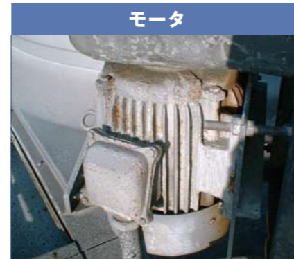
モータ 腐食や劣化が進行し、本来の性能を発揮することができないモータ。
