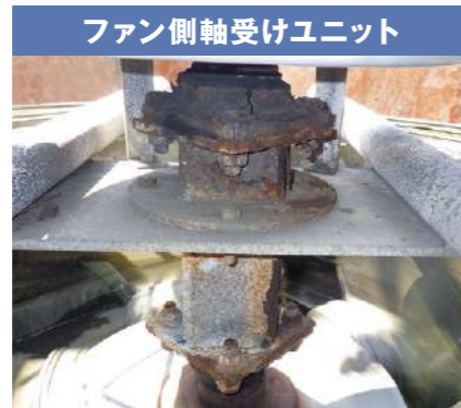
ファン側軸受けユニット 腐食が進行し、不良となったファン側軸受けベアリング。
